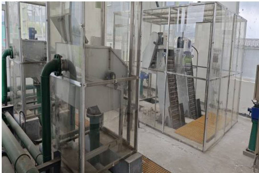
图 3 格栅间集气设施
