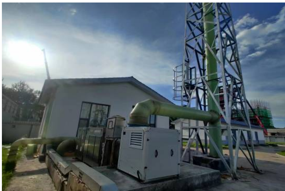
图 4 格栅间光氧除臭设施
