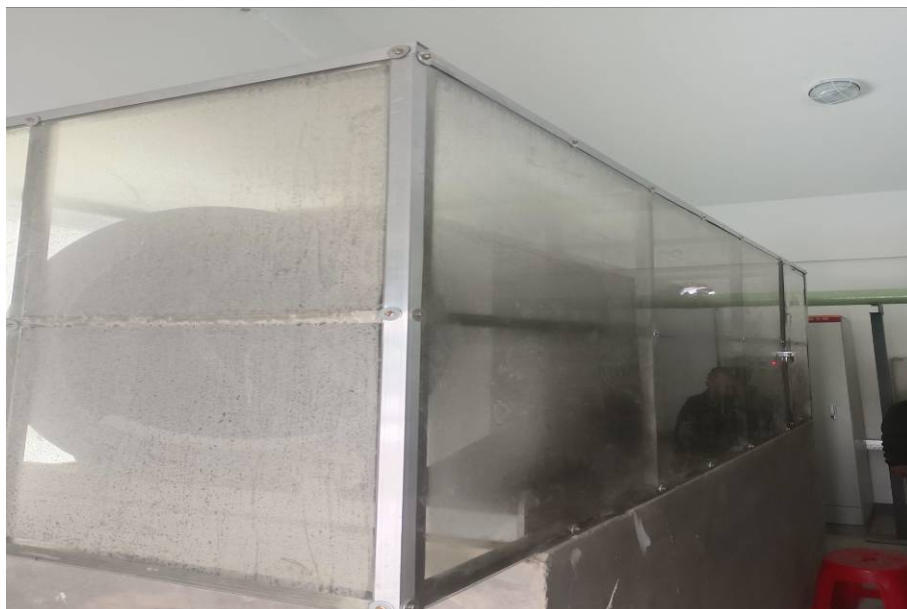
图 3 格栅间集气设施
