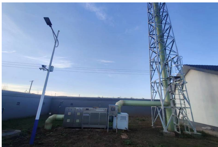
图 4 格栅间光氧除臭设施
