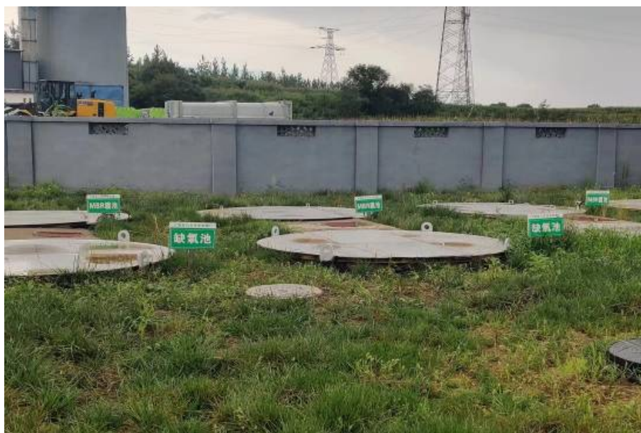
图 5 污水处理设施封闭措施
