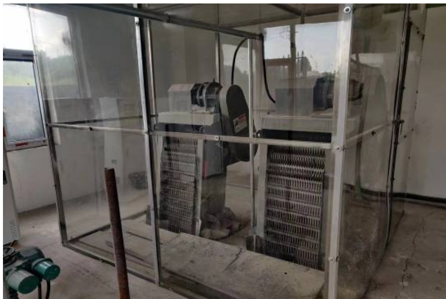
图 3 格栅间集气设施
