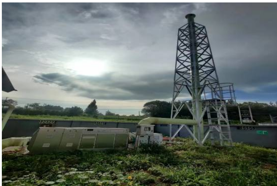
图 4 格栅间光氧除臭设施
