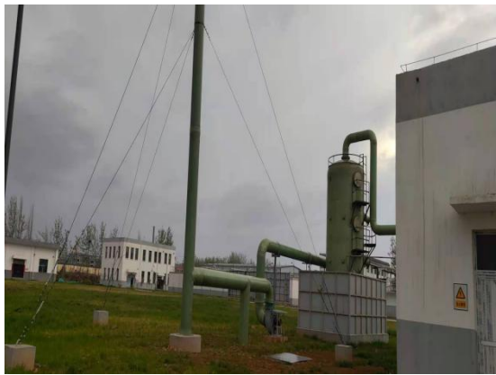
生物除臭设备
