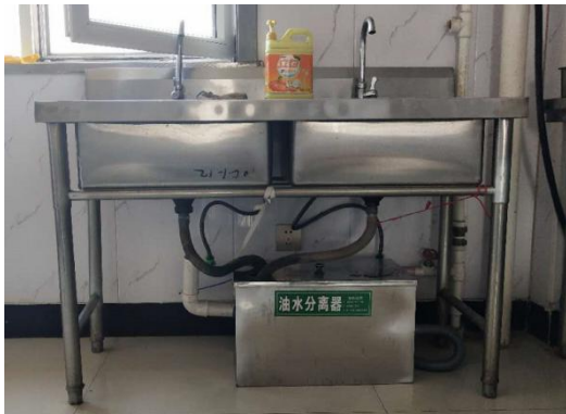
十二楼厨房油水分离器
