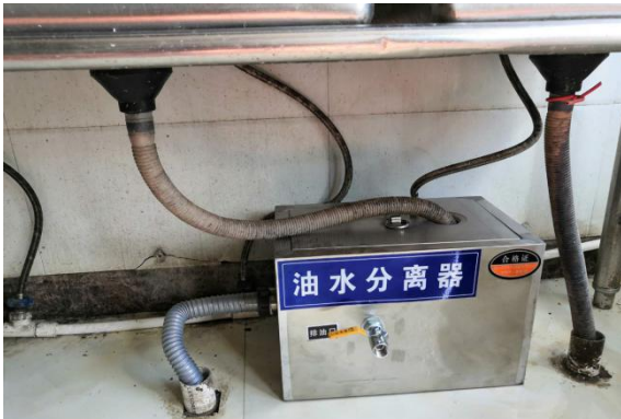
二楼厨房油水分离器
