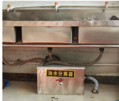
三楼厨房油水分离器
