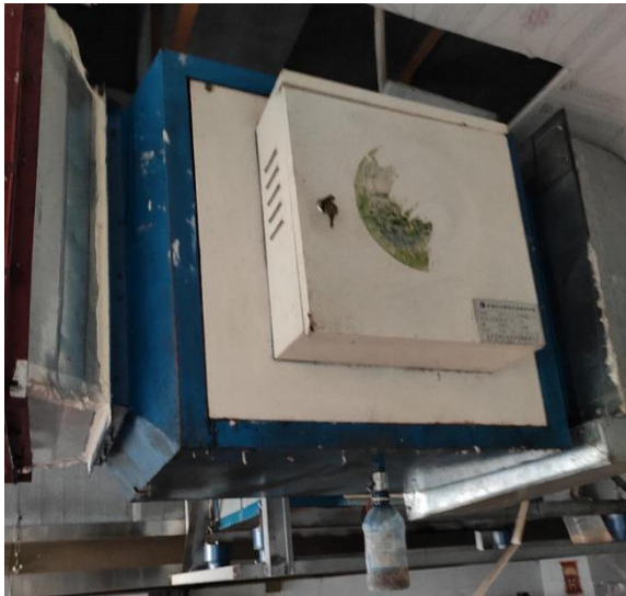
二楼厨房油烟净化器
