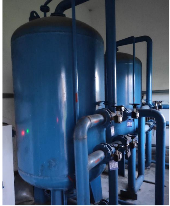
污水处理站活性炭过滤器
