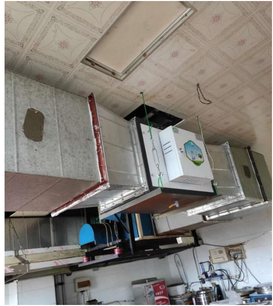
三楼厨房油烟净化器
